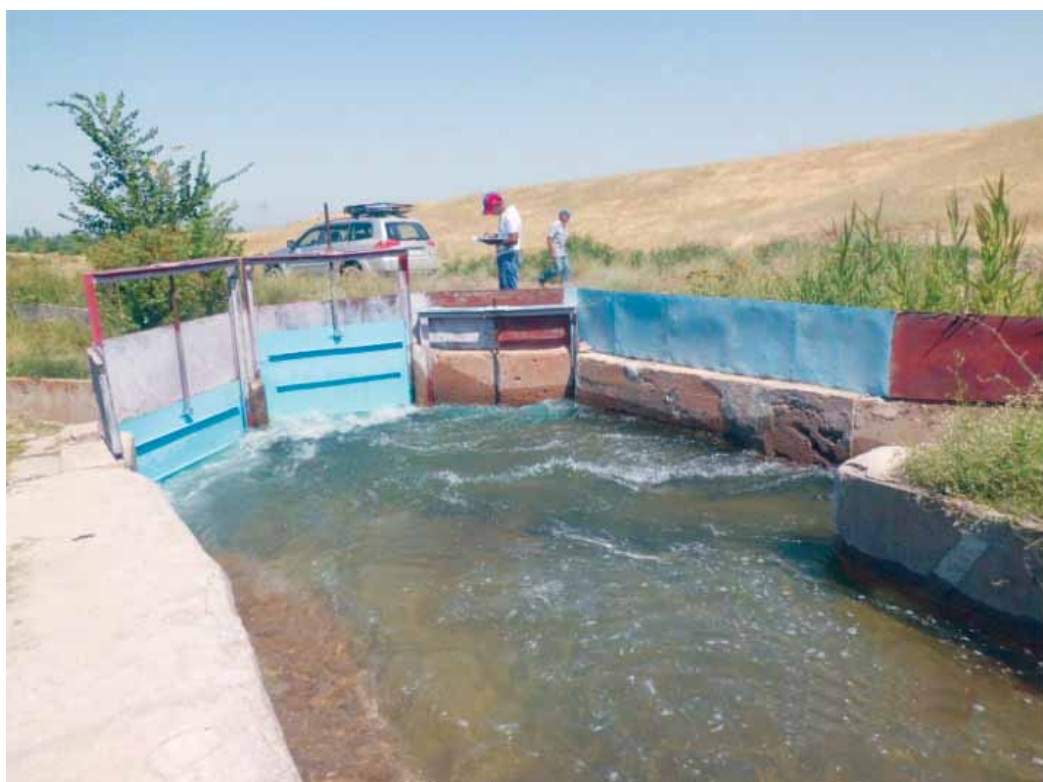
Гидроузел на МК Майлибай
